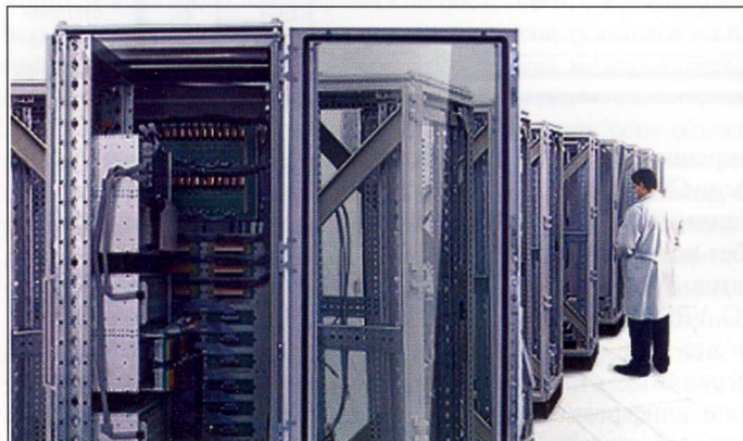
Рис. 1. Шкафы систем АСУТП
